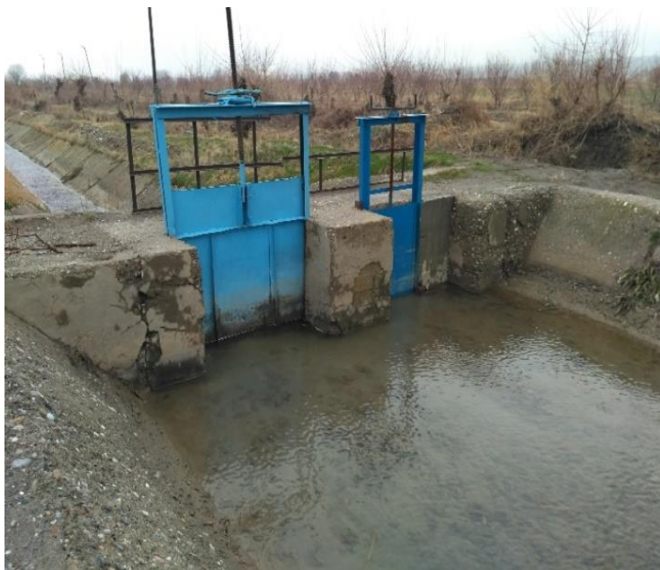
Фото 6: Водорегулирующие сооружения на Ходжабакирганском канале в районе Б. Гафурова (Фото: Далер Домулоджанов, 2016 г.)
